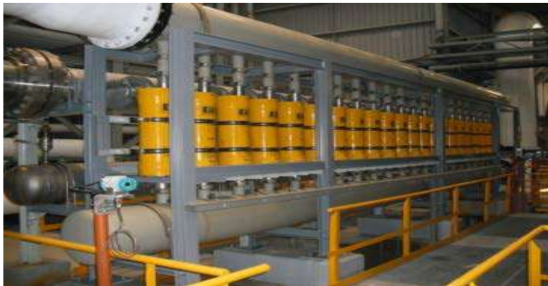
Figure 23. Système de récupération d'énergie.
