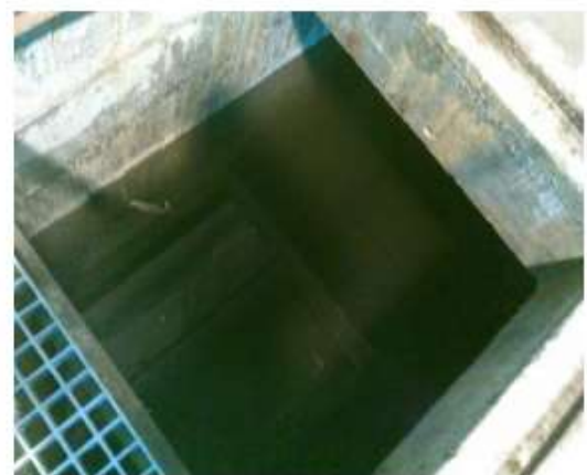
Figure 16. Bassin de Captation .
