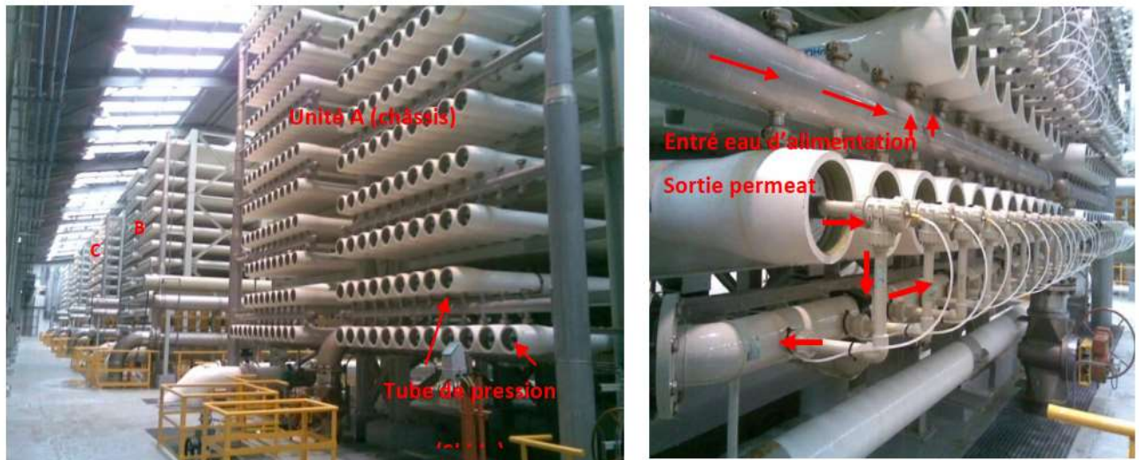
Figure 21. Unité d'osmose inverse .
