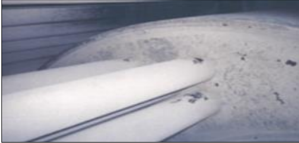
Figure II.19 : Entartrage d'une chaudière à tube de fumée ( p=15 bars) [14]
