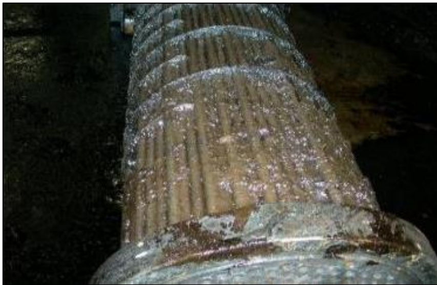
Figure II. 16 : Encrassement de l'échangeur de chaleur (photo réelle) [19]
