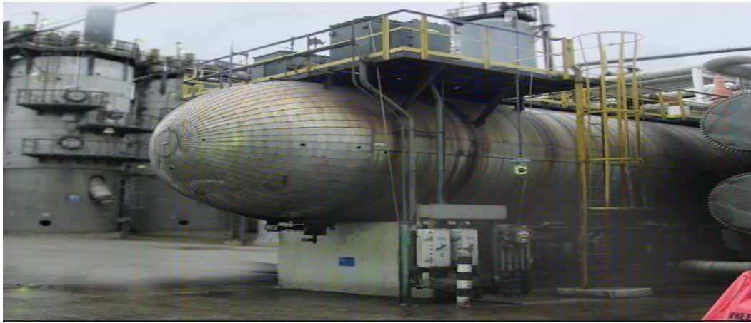
Figure. III.7 Dessaleur électrostatique V51 de l'unité 11 topping
