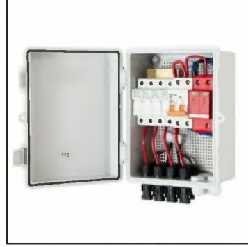
صورة 40: صندوق التوصيل PV Combiner box
