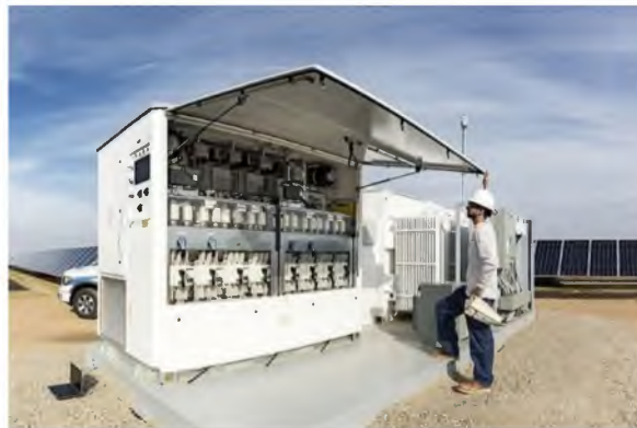
صورة 38: محول مركزي central inverter
