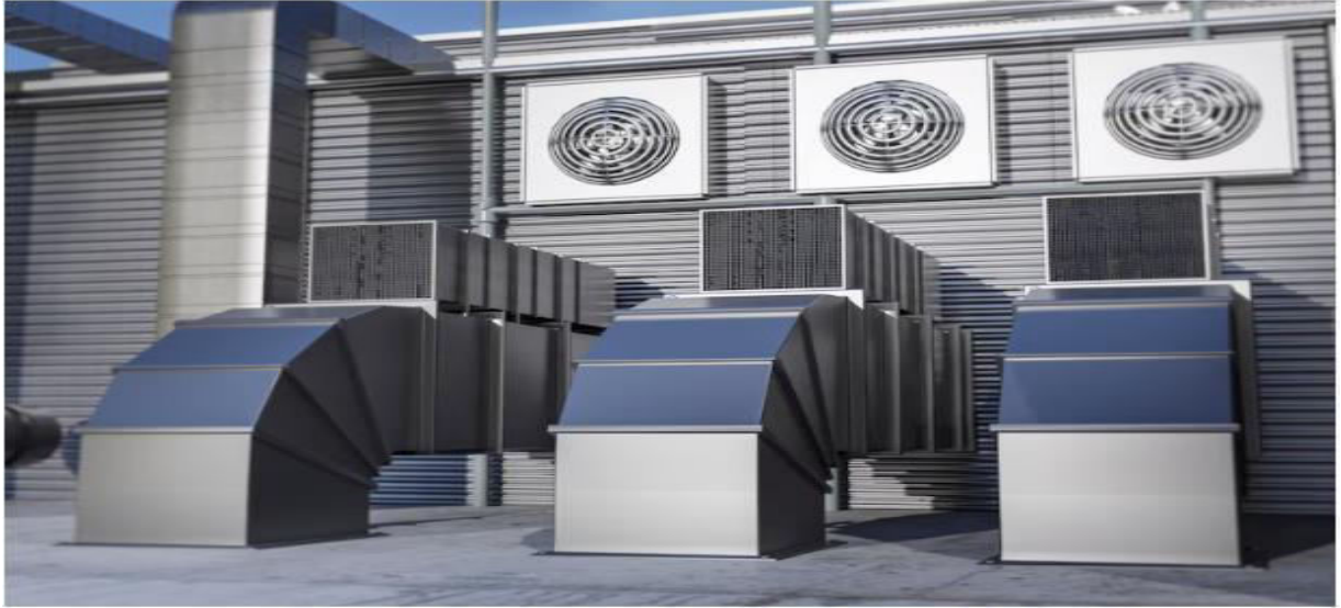
Figure II.1. Partie extérieure de l'HVAC
