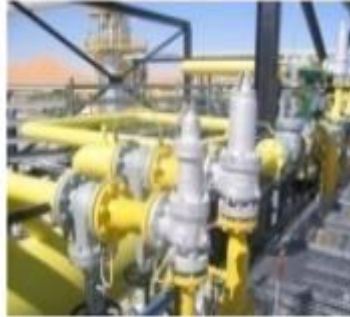
Figure III-5 Soupape de sécurité
