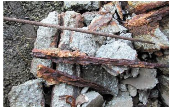
Fig II.5 : Les aciers corrodés (en bas) comparé à un acier sain(en haut) [15].
