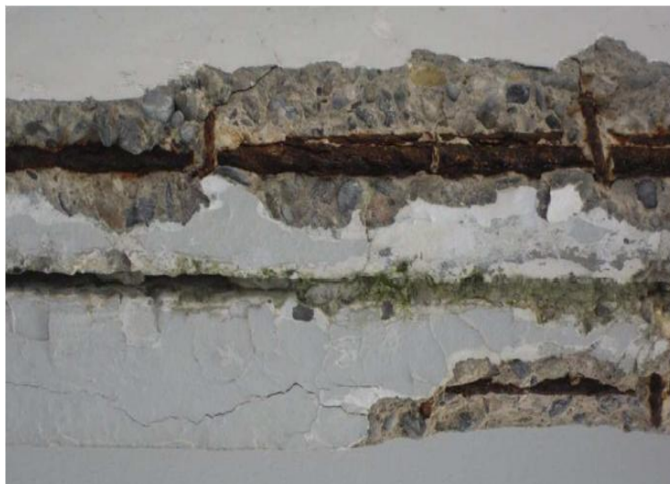
Fig II.12 : Corrosion généralisée des armatures (par carbonatation) sur une poutre en béton armé [37].
