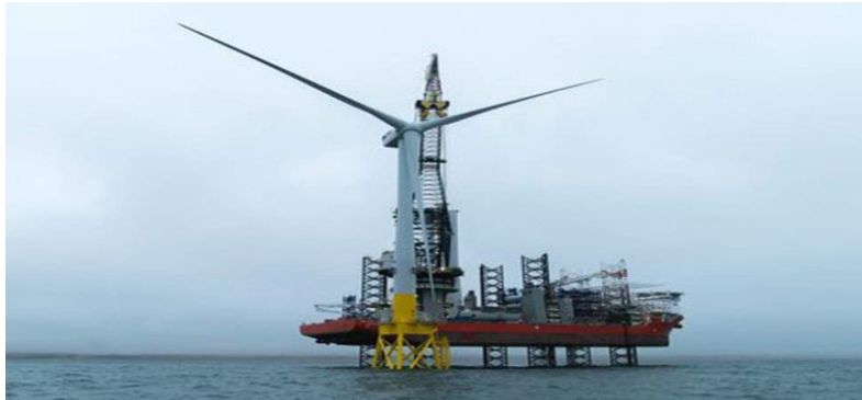
Figure II. 2 Les opérations de maintenance de la boîte de vitesse
