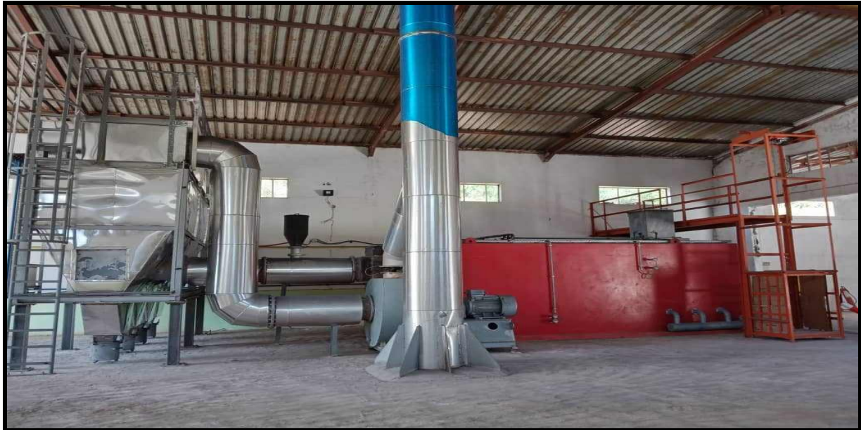
Figure 8: Figure représentant l'incinérateur de l'entreprise BOURRICHE
