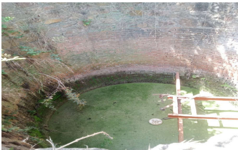
Figure 42: Puits asséché, non nettoyé au niveau du verger de l'Université.
