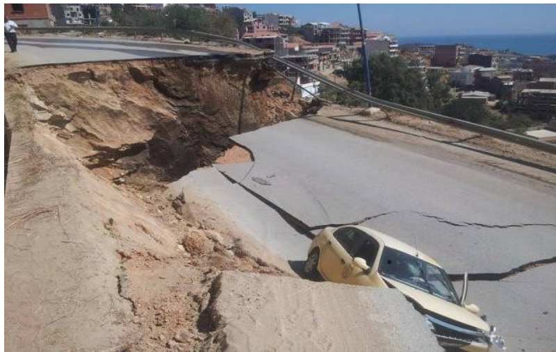
Figure I.7 : affaissement de terrain survenu le 7 Septembre 2014 sur le tronçon d'autoroute d'Annaba reliant Seraidi à Boukrate (jeune-independant.net, publié le 08 sept. 2014).
