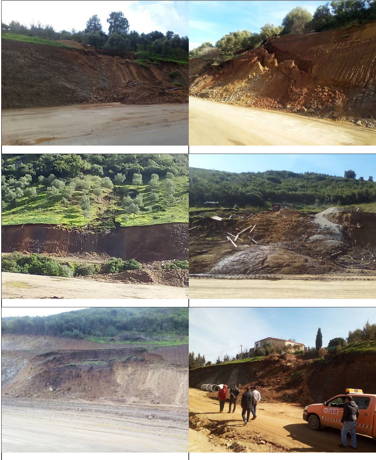
Figure III.6 : glissements de terrain observés au niveau de la RN43 au lieu-dit Lekchar-commune de Bouchetata en 29/01/2019.
