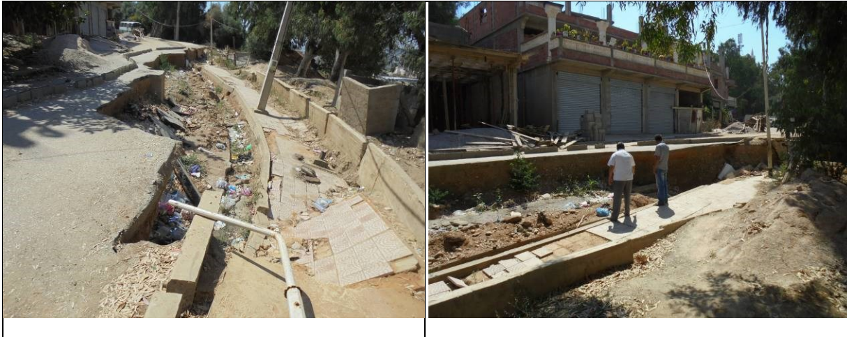
Figure III.16 : Vue du glissement Hamrouche Hammoudi, au nord de la cité 176 logements EPLF, février 2005.
