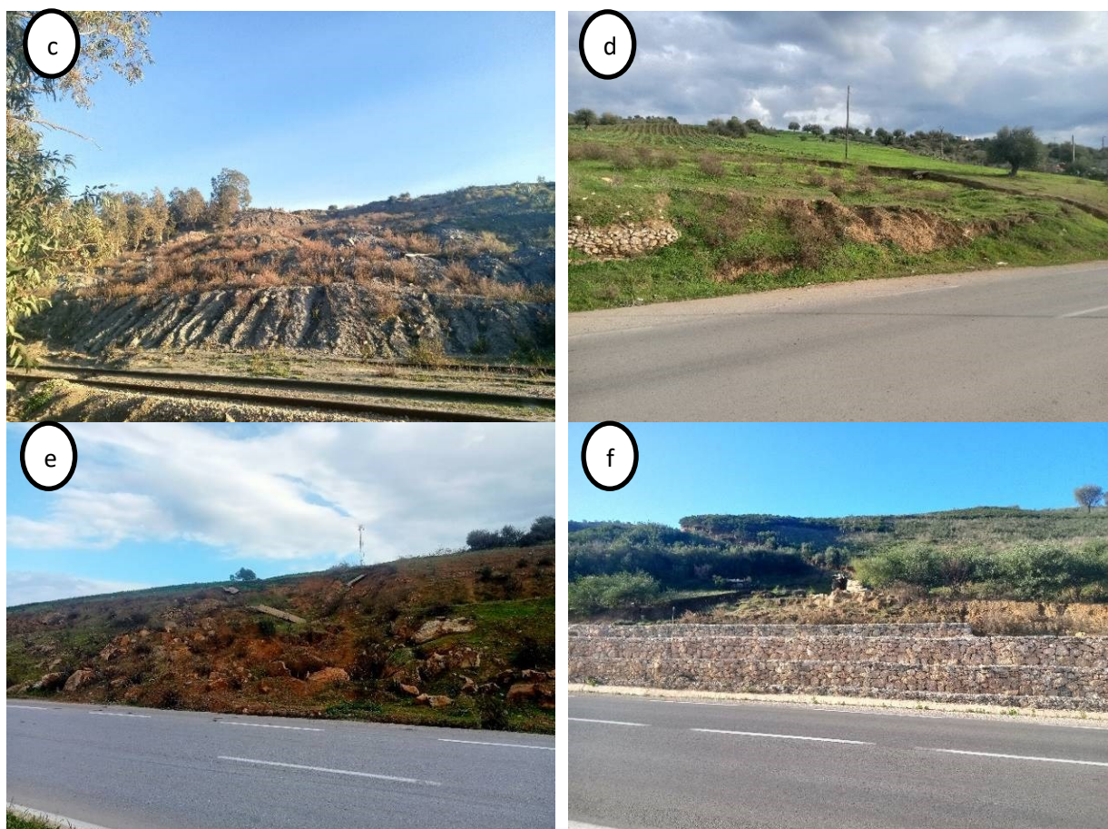
Figure IV.7 : Glissements de terrain observés aux proximités des réseaux routiers de la wilaya de Skikda (Mebirouk et al., 2024). ( a) et ( b) glissement de terrain de type rotationnel sur la route de wilaya n° 29 (Casino), où a) s'est déclenché en 2019, avec une vue plus basse, tandis que b) s'est produit en 2005, avec une vue aérienne ; c) glissement de terrain de type translationnel observé le long de la ligne de chemin de fer (Ain Bouziane) en 2018 ; d) glissement de terrain rotationnel observé sur la route nationale n°44-AA (Salah Bouchaour) en 2018 ; e) glissement de terrain translationnel également observé sur la route nationale n° 44-AA (Syayera) en 2018 ; f) glissement de terrain rotatif observé sur la route nationale n° 43 (Lekchar) en 2020.
