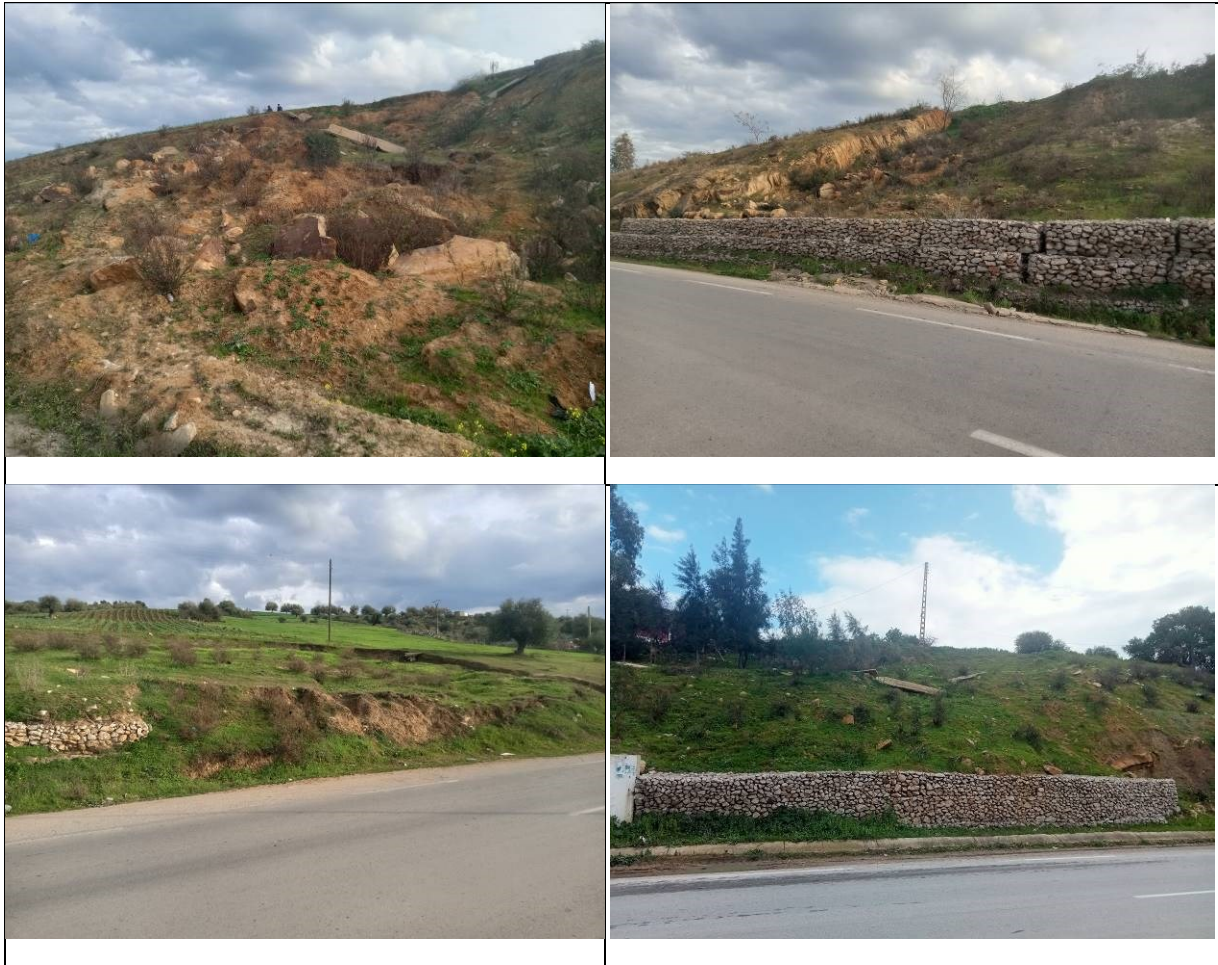
Figure III.10 : glissements de terrain observés sur la RN 44AA entre 2014 et 2015, lors et après le dédoublement de la route.
