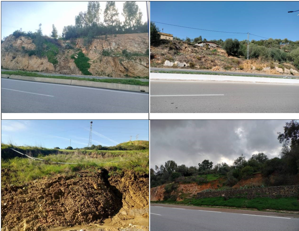
Figure III.9 : glissements de terrain observés sur la RN 03 entre 2018 et 2024.
