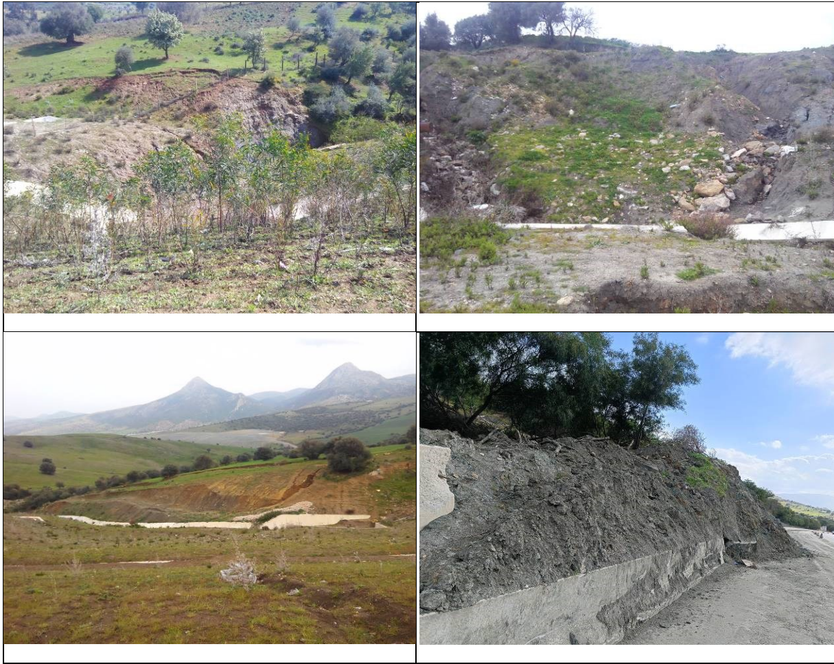
Figure III.12 : Illustration des glissements de terrain potentiels affectant l'autoroute Est-Ouest entre 2010 et 2018.
