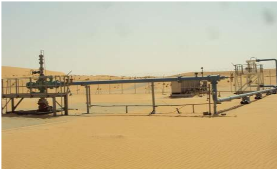
Figure I.11: Les puits de production d'eau Albien/Barrémien.
