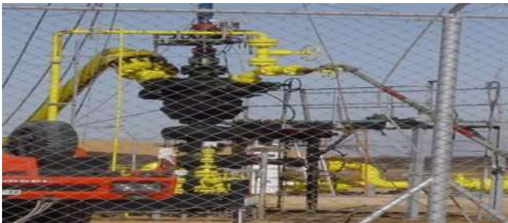
Figure I.8 : Les puits d'injections de gaz.
