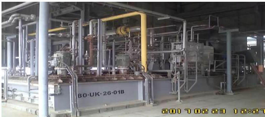
Figure II.17 : Injection Gas compresseur.
