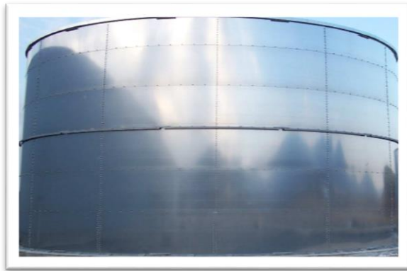
Figure III.5 : réserve d'eau anti incendie.
