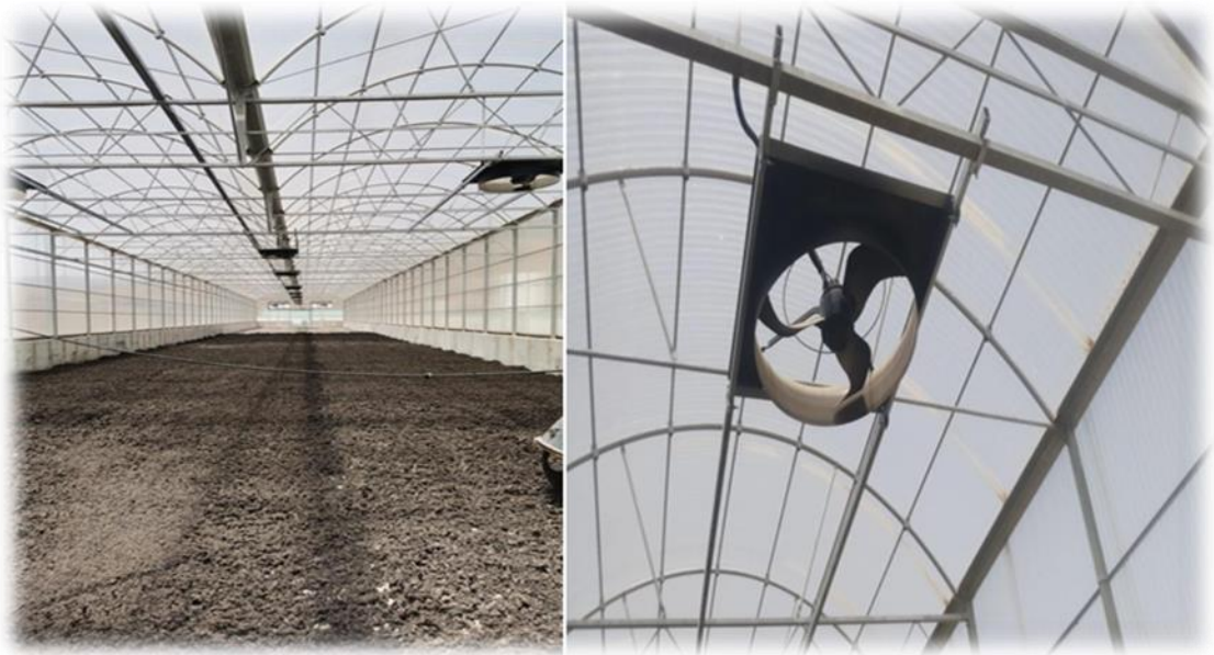
Figure III.17 : ventilateurs de brassage d'air intérieur.
