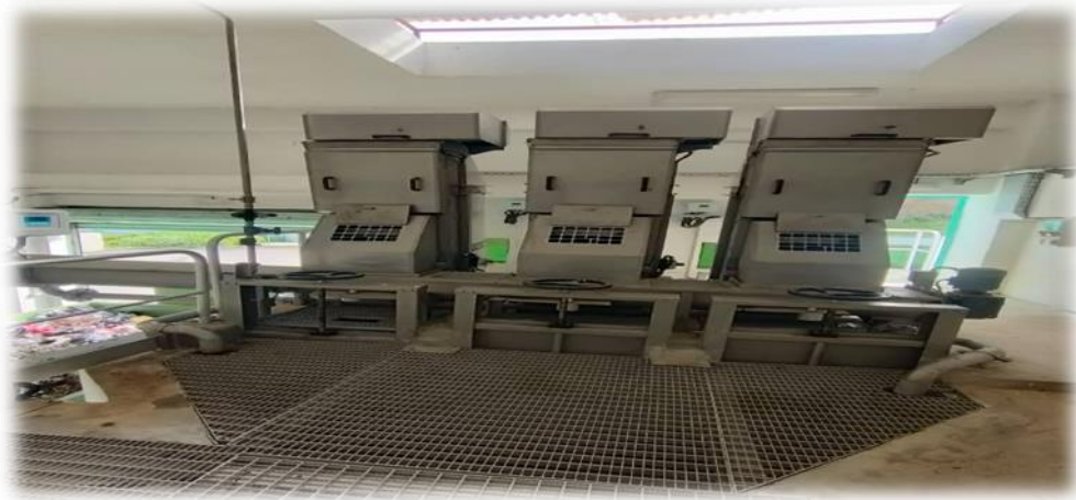
Figure III.4 : les dégrilleurs fins.
