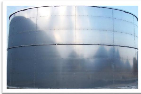
Figure III.5 : réserve d'eau anti incendie.
