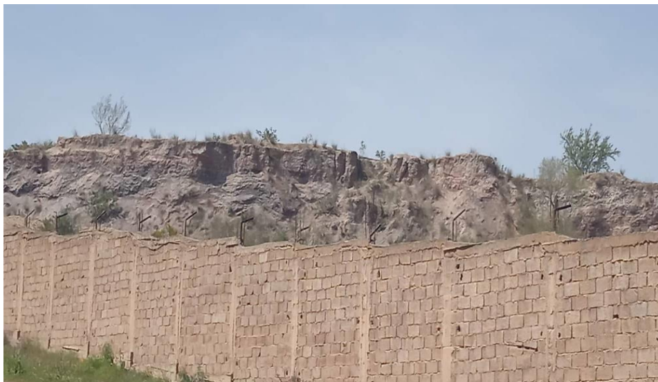
Figure 16. Des tonnes des terrils déversés derrière le mur de la mine (sortie du 11 Avril 2022)
