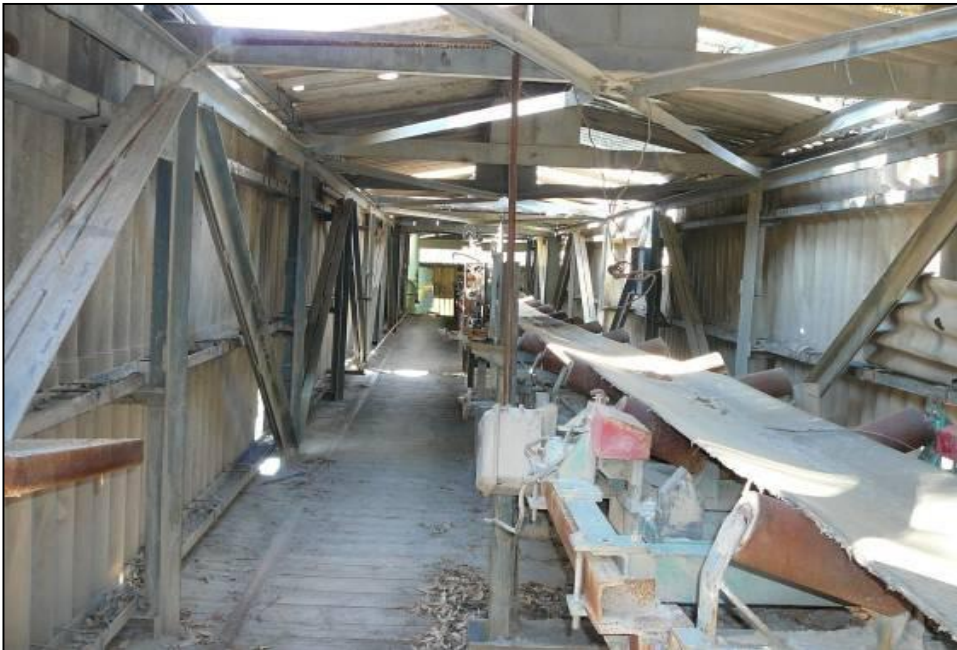
Figure 05. Bande transporteuse reliant le concasseur à la trémie d'alimentation des fours
