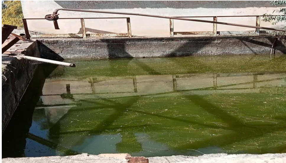
Figure 15. Bassin d'évacuation d'eau chaude de la refroidissement des machine (sortie du 11 Avril 2022)
