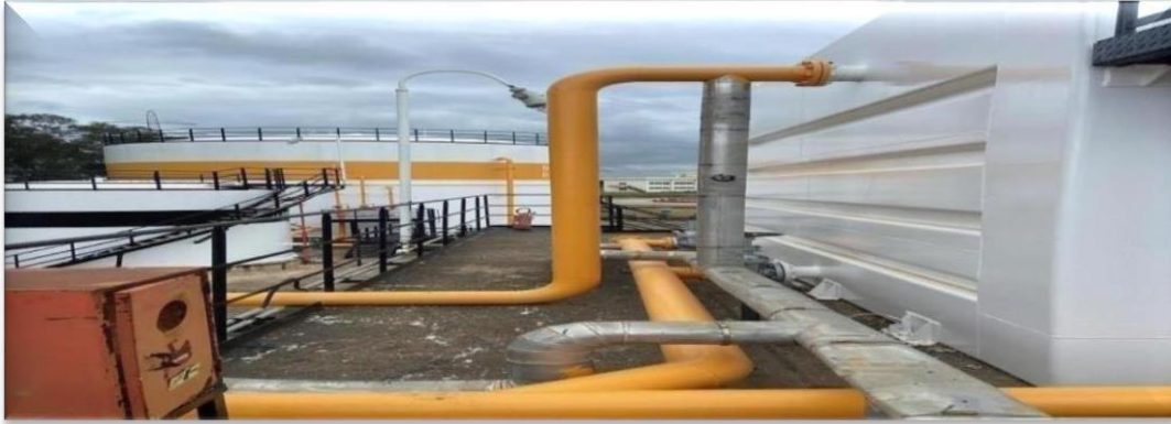
Figure 6 : Bacs d'injection chimique
