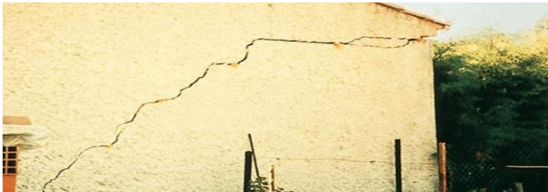
Figure. I .9 : Fissures au niveau d'une structure de génie civil.
