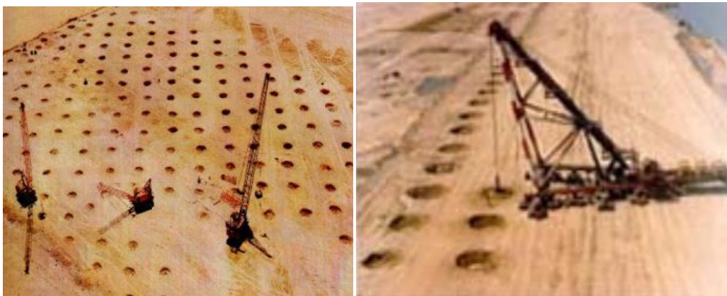
Figure II -5 : Réalisation du compactage selon un maillage bien défini (documents de Ménard soltraitement®)
