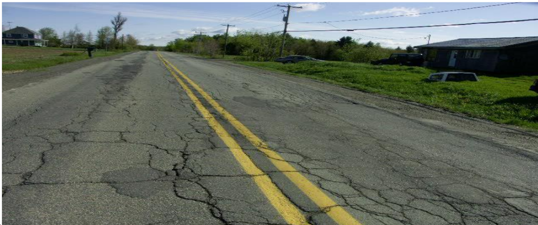
Figure I.10: Déformation d'une chaussée de sol instable
