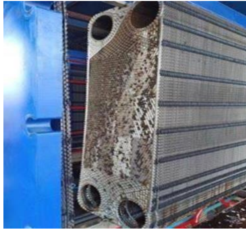
FigureII-16:colmatage d'un échangeur à plaque
