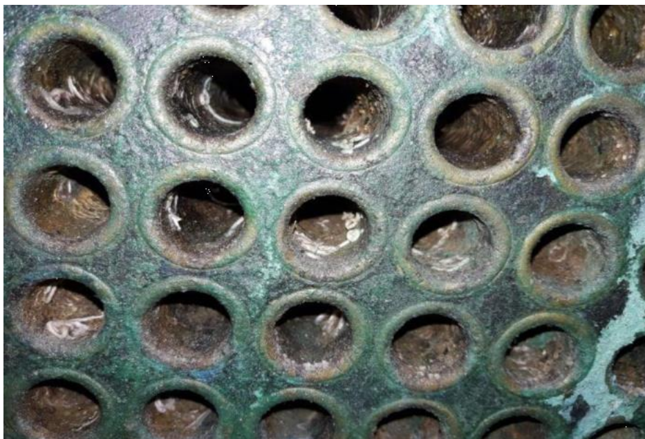
figureII-15:encrassement des tubes réels
