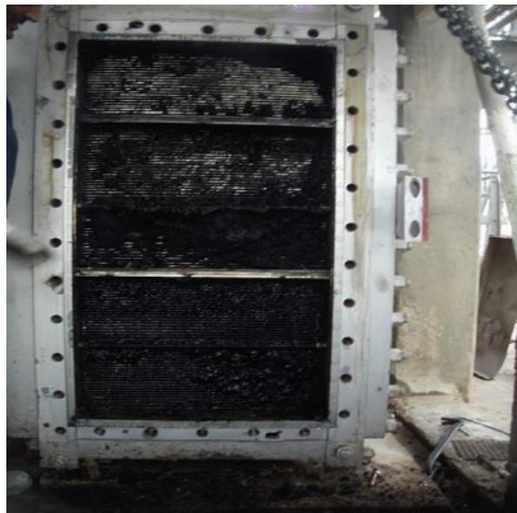
figure III.21 L'état d'échangeur a plaque(25)
