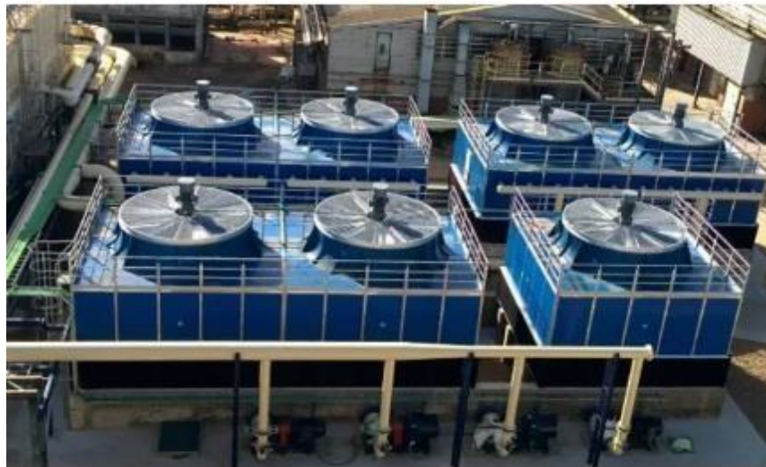
Figure II. 4 : condenseur à air [19]
