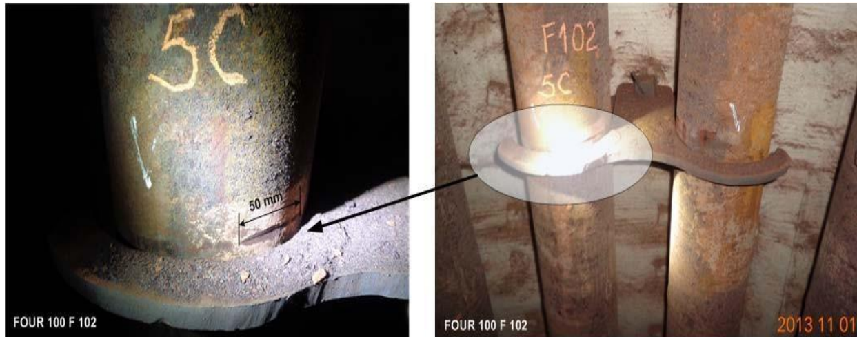
Usure par friction entre le support "Guide tube" et le "tube" au niveau de la zone radiante. - Profondeur: 01 mm - Longueur: 50 mm
