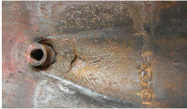
Figure I.4 : Corrosion sous contrainte [10].
