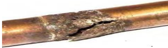
Figure I.7 : corrosion par érosion [10].
