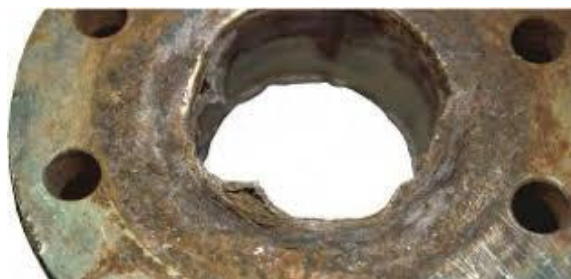
Figure II. 5 : Corrosion caverneuse des aciers inoxydables .
