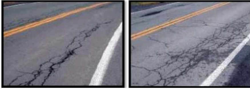
Figure II.5. Fissures en pistes des roues [31].
