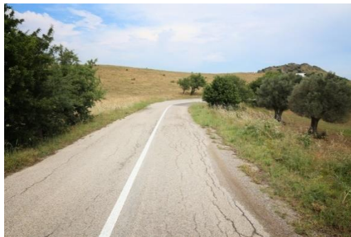
Figure II.7. Fissures longitudinales des rives [25].
