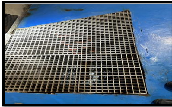
Figure II 4 : Bassin de captation
