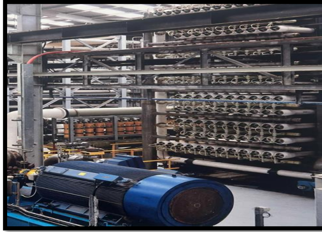
Figure II 9 : L' osmose inverse (Desaladora)
