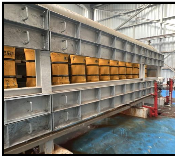
Figure II 10 : La récupération d'énergie (Desaladora)
