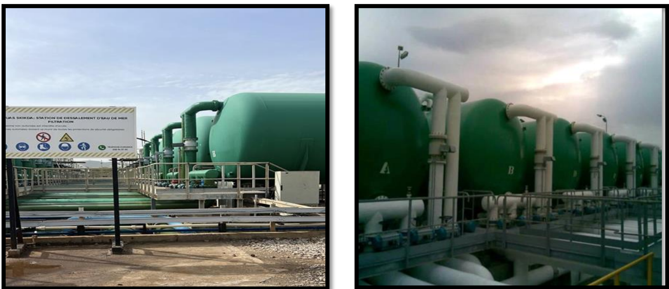
Figure II 6 : Les bacs de filtration (Desaladora)
