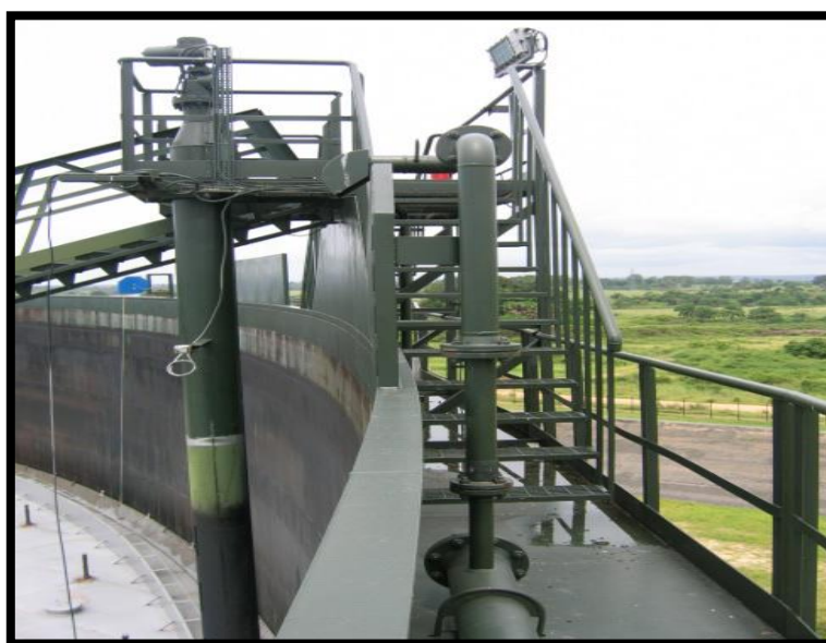
Figure III.3 : Accessoires d'Accès au Réservoir [14].
