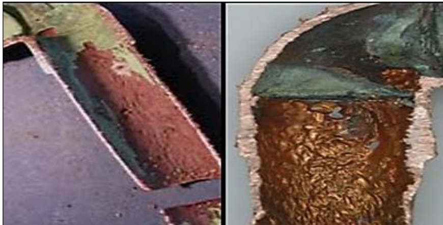
Figure I.7: Corrosion par érosion [13]
