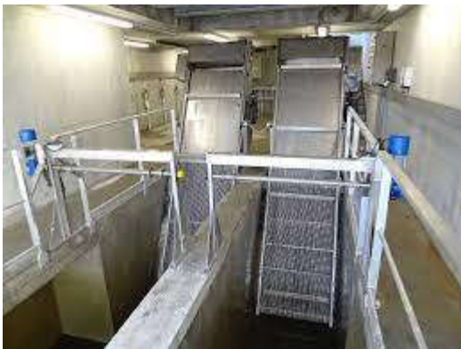
Figure II. 2 : Un dégrillage grossier.
