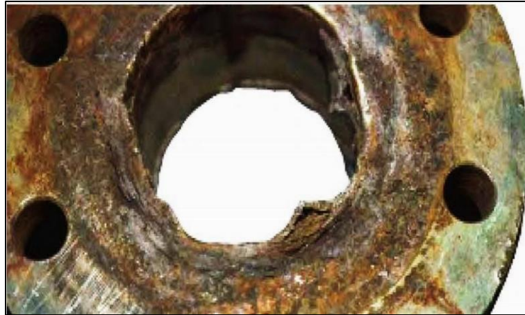
Fig.I.6 : Corrosion par crevasses.
