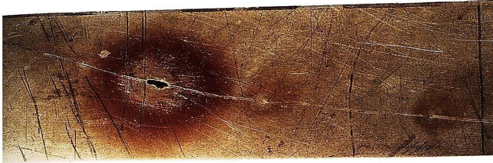
Figure .I.11: corrosion par piqûres.[7]
