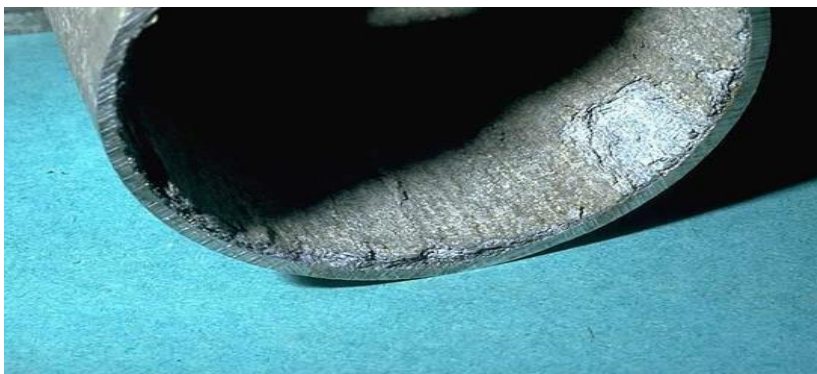
Figure.I.7 : Corrosion feuilletant d'une canalisation en alliage d'aluminium véhiculant de l'eau. [5]
