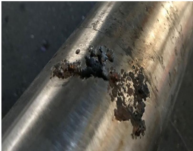
Figure.I.2 : La corrosion par piqûres petites cavités à la surface d'un métal.[5]
