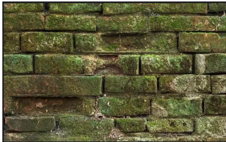
Figure 1.13. Manifestation d'une attaque biologique ( https://deavita.fr/maison/comment-enlever-la-mousse-sur-un-mur-exterieur-briques-beton-bicarbonat-vinaigre-javel-541145/?image_id=541224 consulté le 29/06/2022)
