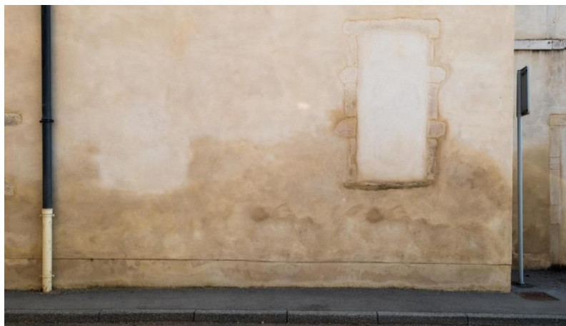
Figure 1.9. Manifestations de la remontée capillaire dans le vieux bâti ( https://www.ramond-maconnerie.com/lutter-contre-le-probleme-dhumidite-revel consulté le 29/06/2022)
