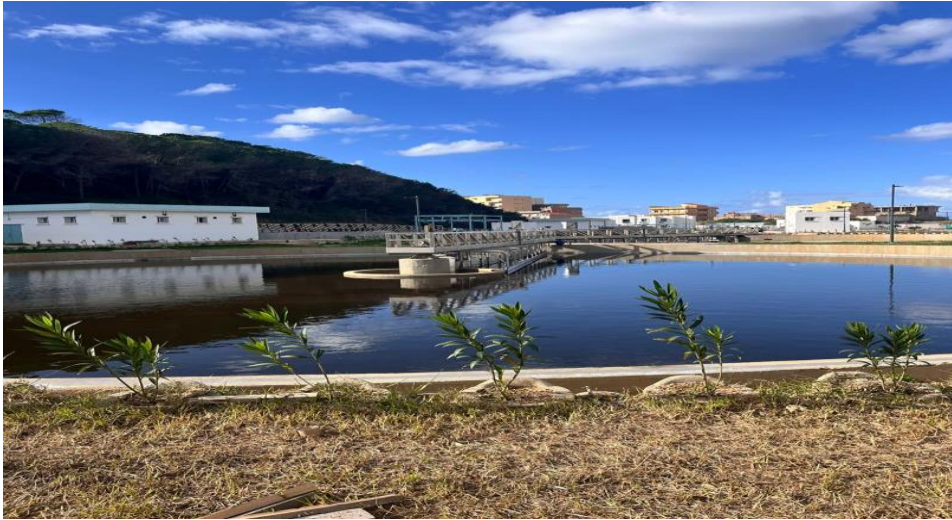
Figure.II.7 : Bassin de clarification
