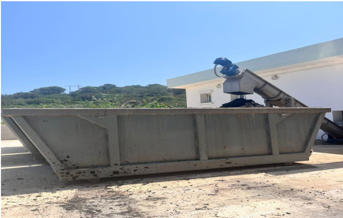
Figure.II.8 : Benne des boues
