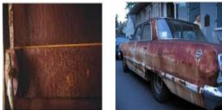
Figure I.2 : Corrosion généralisée : exemple d'une porte et d'un véhicule corrodés.
