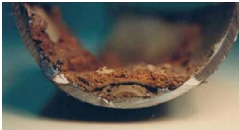
Figure III.2 : corrosion sous dépôt, dans une canalisation non inclinée.
