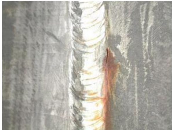
Figure I.25 : Corrosion par crevasses.
