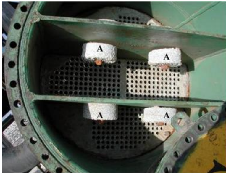
Figure III.12 : Anode sacrificielle d'aluminium installée dans un échangeur de chaleur.
