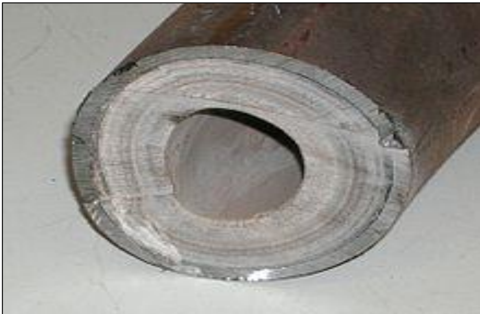
Figure I.1 : Dépôts concentration de tartre dans une tuyauterie [10]
