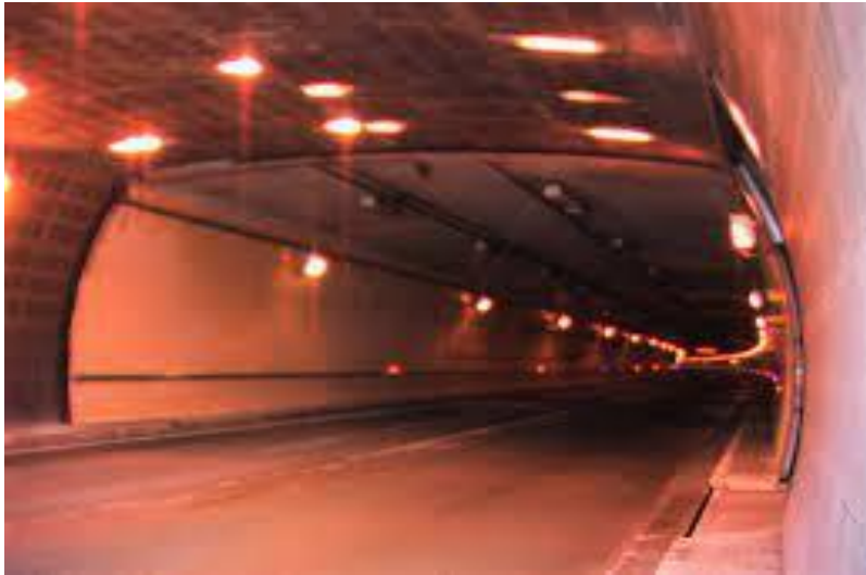
Figure2.22 : L'éclairage Des Tunnels
