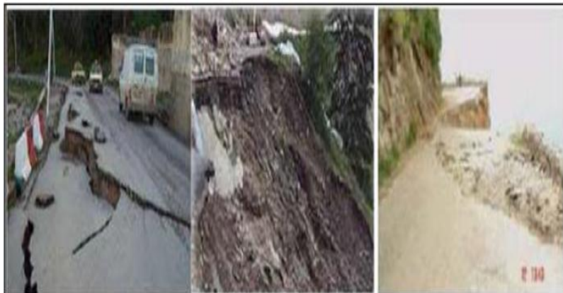
Figure 1.12: Instabilité des talus (cas des routes)
