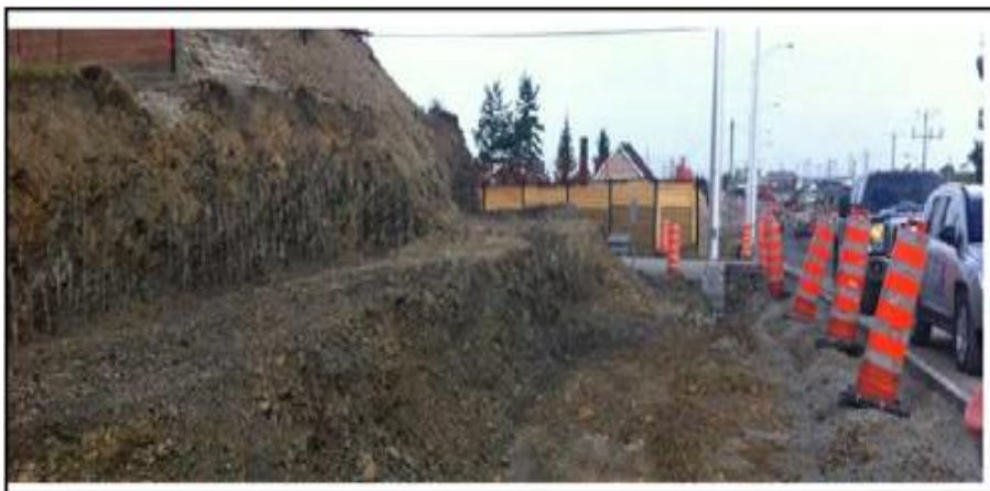
Figure 1.14: Les déblais et les excavations à la base du talus
