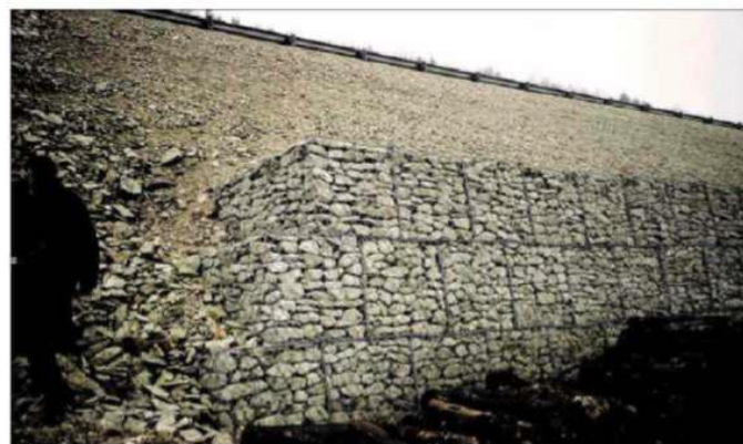
Figure4.13 : Exemple d'ouvrage souple : Mur en gabion (Service d'Etude Technique des Routes et Autoroutes [35].
