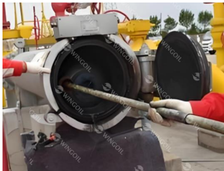
Figure II.4 : Procédé de nettoyage mécanique des tubes [17].
