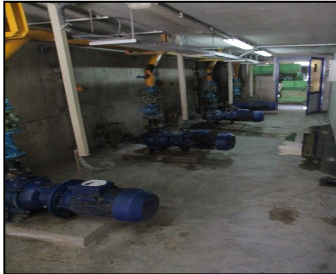
Figure III.7 : Pompes à sable
