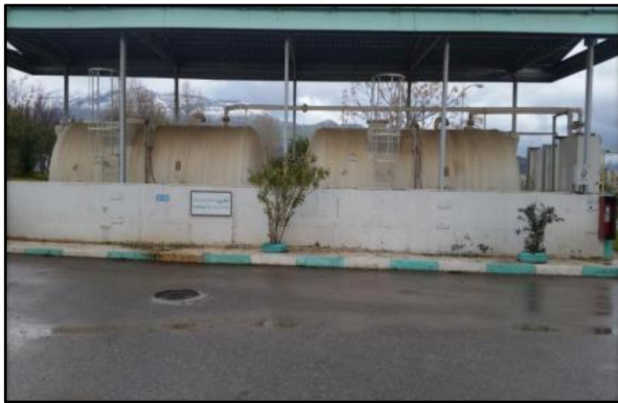
Figure II.19 : Poste de chlorure ferrique ( FeCl_3 )
