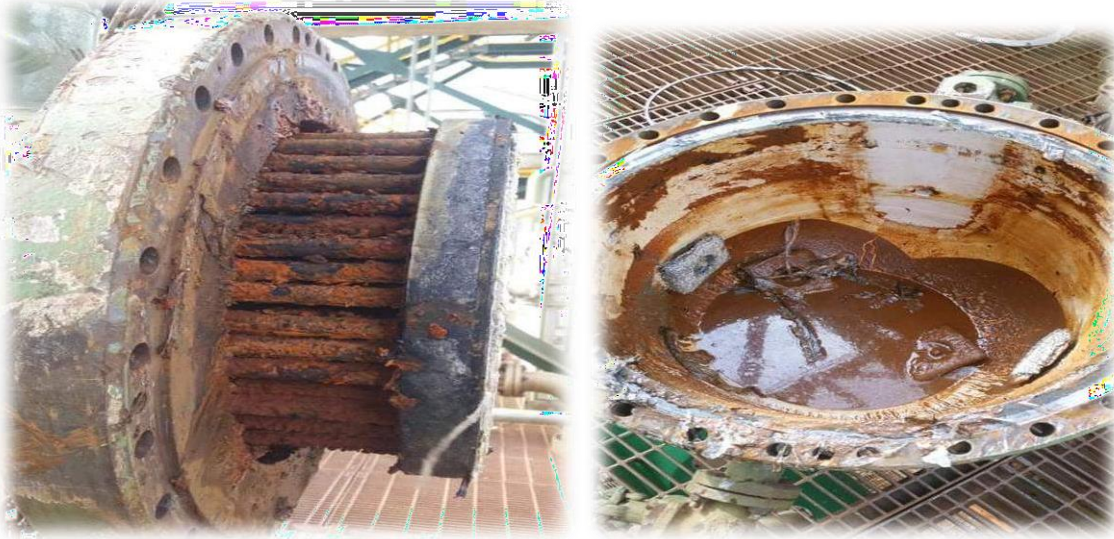
Figure IV. 3 : Images réelles de l'état dégradé du condenseur 701-E-5 dans la période du stage.
