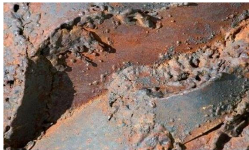
Figure I.3.1.6. Corrosion par érosion [58]
