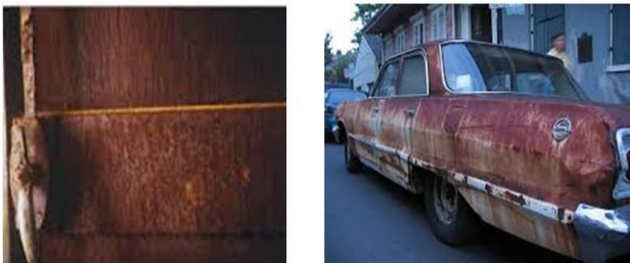
Figure I.5 : Corrosion généralisée : exemple d'une porte et d'un véhicule corrodés.
