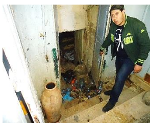
Figure 3 23: L'accès aux caves est encombré de déchets.
