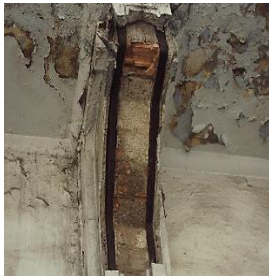
Figure 3 31: Une console endommagée.
