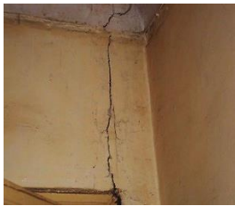
Figure 3 15 : Le mur de séparation en briques est fissuré.
