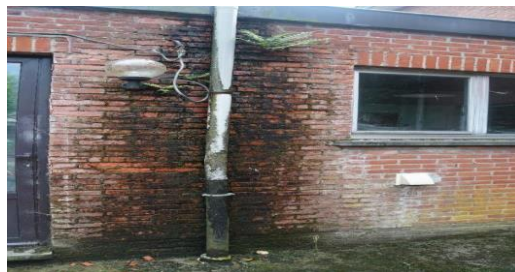
Figure 2 2: Une détérioration des briques, au contact avec l'eau en raison d'un problème d'étanchéité (Florence & al, 2021).
