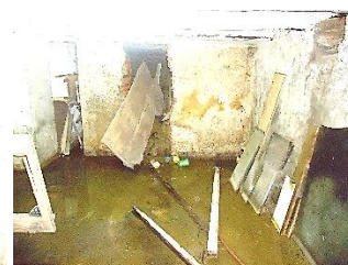
Figure 3 26: Une caves inondé par les eaux d'assainissement et les eaux sous terraines.
