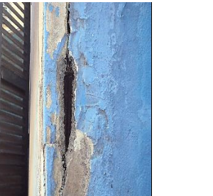
Figure 3 34: Un mur porteur, latéral, présente de profondes fissures.
