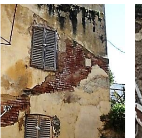
Figure 3 37: L'altération de la peinture et l'apparition de moisissures.
