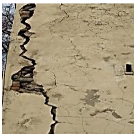
Figure 3 40: Des fissures et détérioration des murs porteurs.
