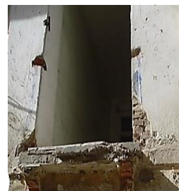
Figure 3 42: La porte fenêtre a complètement disparu.
