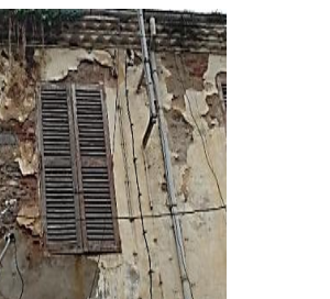
Figure 3 38: Décollement des couches d'enduits de la façade.
