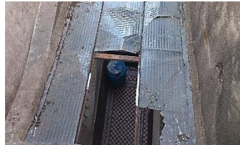
Figure 3 13: Une flamande de type verrière en très mauvais état.
