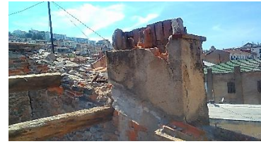
Figure 3 14: Une cheminée en briques endommagées.
