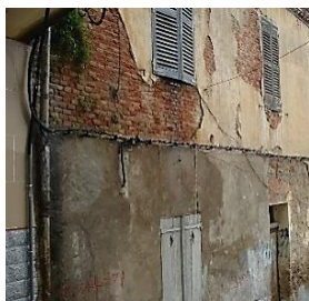
Figure 3 39: Les efflorescences et la poussée de la végétation sur la façade.
