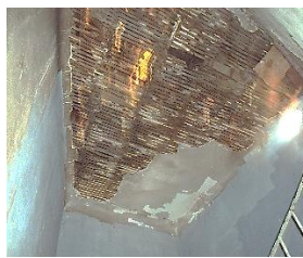
Figure 3 21: Destruction totale de la partie inférieure du plancher en bois.
