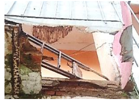
Figure 3 29: Palier de la cage d'escalier entièrement détruit.
