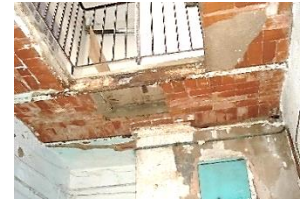
Figure 3 30: La partie inférieure de la cage d'escalier et complètement arraché.
