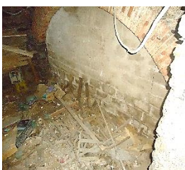
Figure 3 25: Des caves encombrées de débris.
