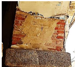
Figure 3 16: Une arcade était fissurée et comblait de ciment.
