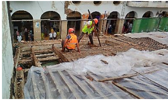
Figure 3 12: Des pannes, et les liteaux en bois, entièrement cassés.
