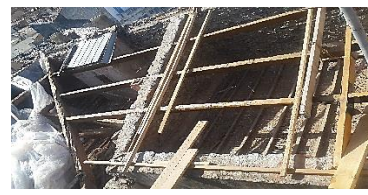
Figure 3 11: La structure en tuile en bois est entièrement détruite.
