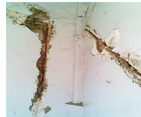
Figure 3 18: Le mur de la façade est fissuré par l'intérieur.
