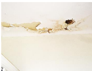
Figure 3 19: Le détachement de la peinture, par l'humidité.
