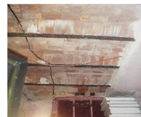
Figure 3 22: L'effondrement partiel du planché et l'apparition de la partie a voûtain.
