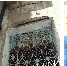
Figure 3 33: Les barreaudages en armatures sont corrodés.
