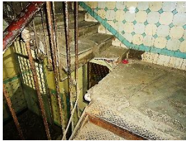
Figure 3 27: Une marche en partie endommagée.
