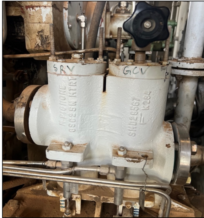
Figure IV.1 Les deux vannes SRV et GCV.
