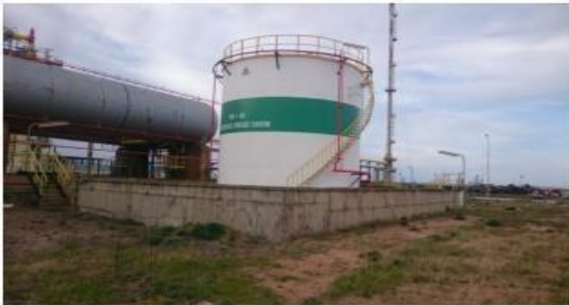
Figure IV.2: Le bac de stockage d'héxène au niveau de CP2K.
