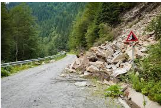
Figure 03: Chute des blocs
