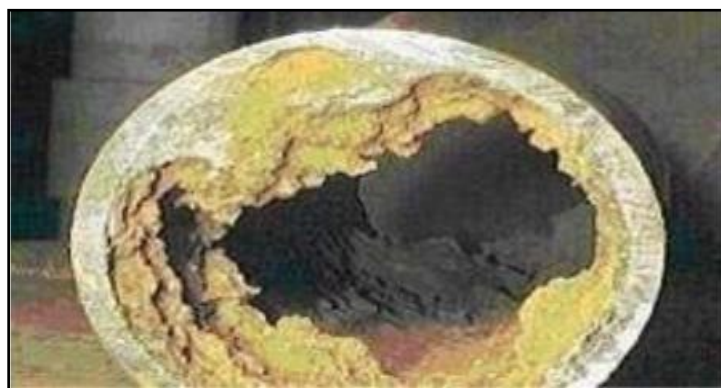
Figure .I.9 : La corrosion caverneuse.
