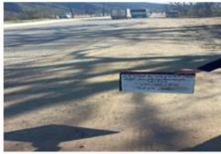
Non revêtu, Dénivelé entre chaussée et accotement PK 06+500
