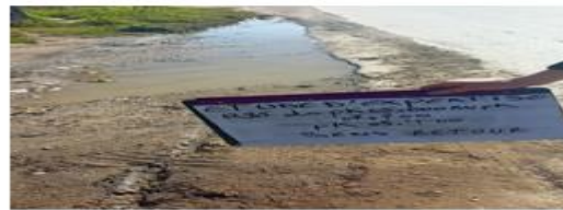
Stagnation des eaux PK 05+400
