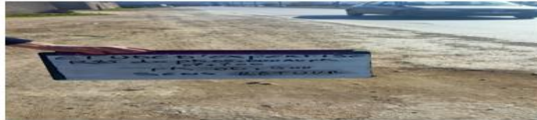
Accotement dégradé PK 06+900
