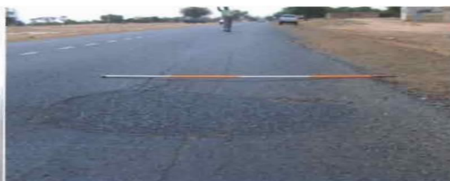
Figure 31 : Ornière sur la chaussée
