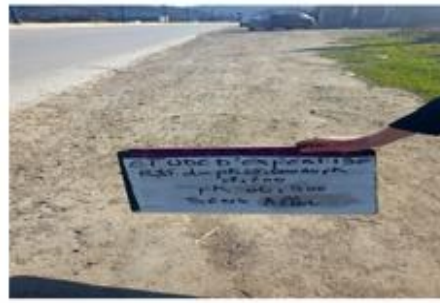
Accotement en Dénivelé couvert par la boue PK 06+900
