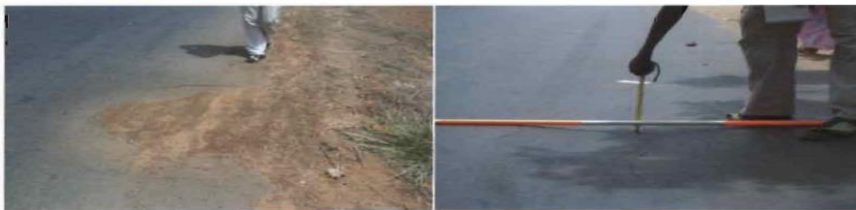
Figure 28 : Affaissement de rive Figure 29 : Affaissement hors rives.
