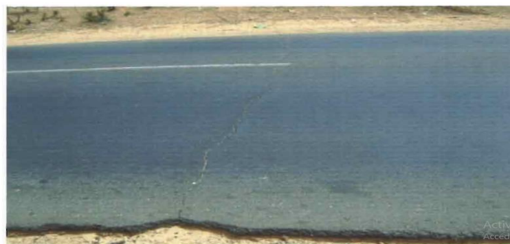
Figure 34 : Fissure transversale affectant toute la largeur de chaussée.
