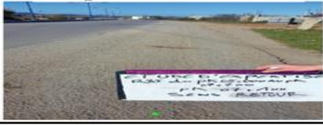
Accotement Revêtu PK 07+100
