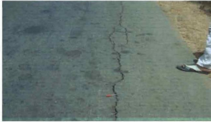
Figure 35 : Fissure longitudinale avec ouverture franche.
