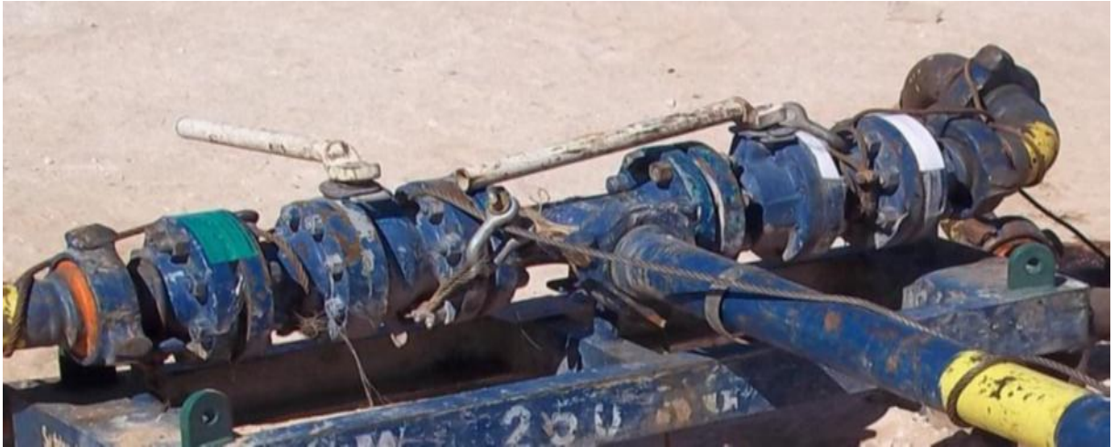
Figure (II-13): Un Manifold de gaz.
