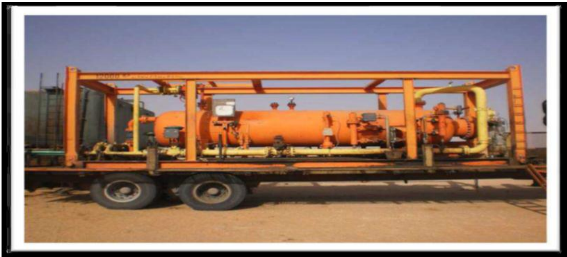
Figure (II-16) : Unité de jaugeage avec séparateur et Bac de stockage.
