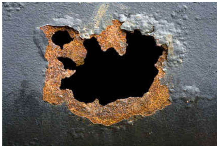
Figure I.4 : la corrosion par piqûre
