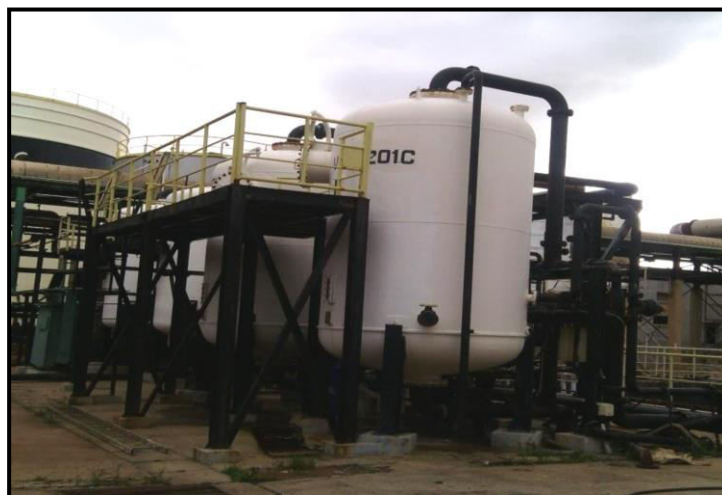
Figure 13 : Photographie d'ioniseur prise de la station de dessalement TCD 6-8000
