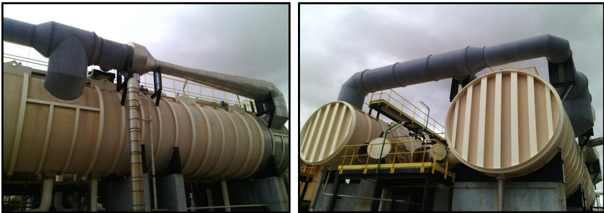
Figure 15 : Photographie du thermo-compresseur prise de la station de dessalement TCD 6-8000
