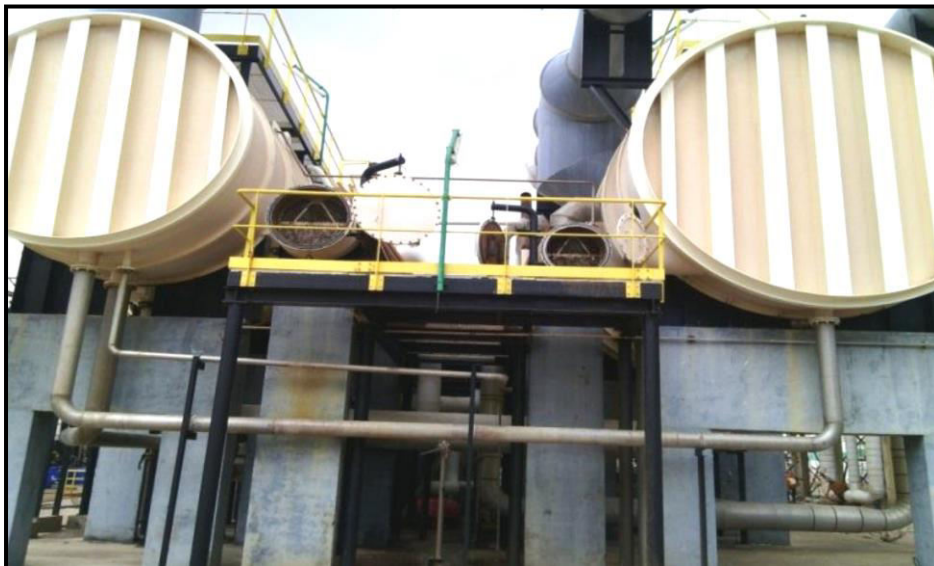
Figure 16: Photographie des tubes U prise de la station de dessalement TCD 6-8000
