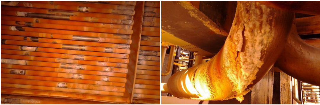
Figure 08 : Photographie d'entartrage sur les tubes intérieurs et extérieurs de l'évaporateur prise de l'unité de dessalement TCD6-8000
