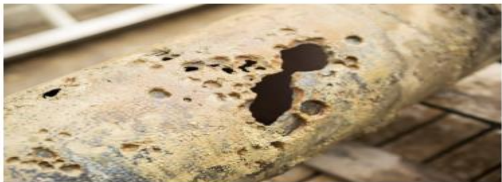
Figure II.18 : corrosion par O 2 .
